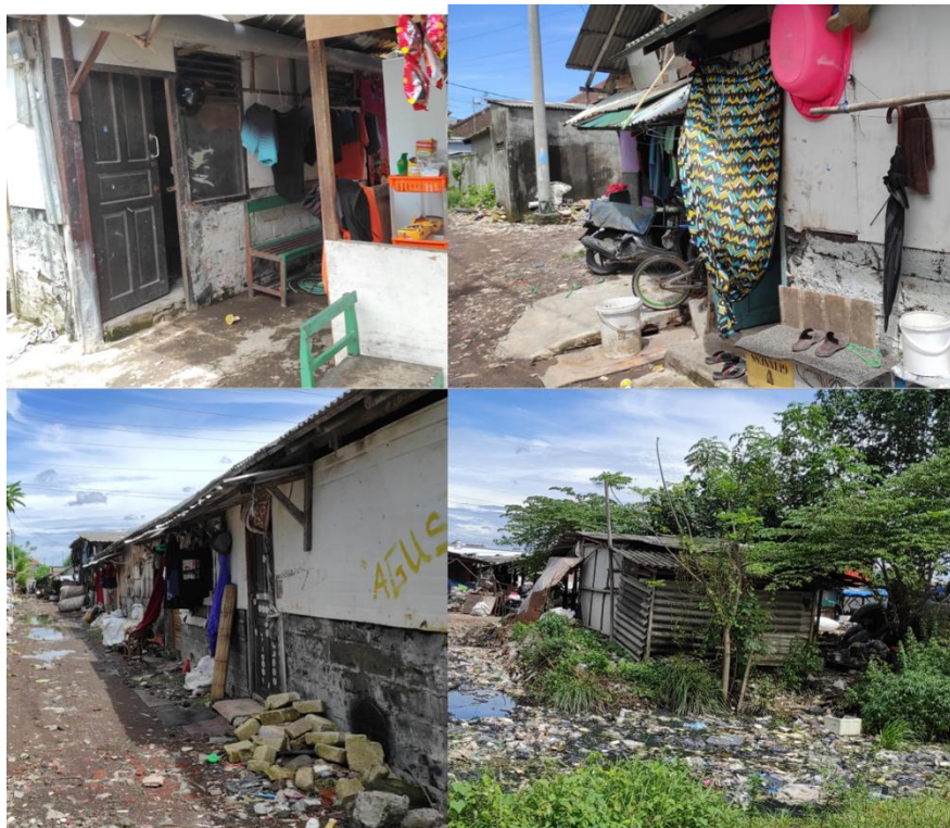
Gambar 3. Kondisi Bangunan Gedung di Kawasan Kumuh Suwung Sumber: Survei, 2024
